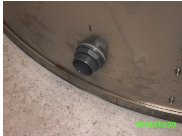
Bild 9: Durchführungskupplung für Sedimentabführung
