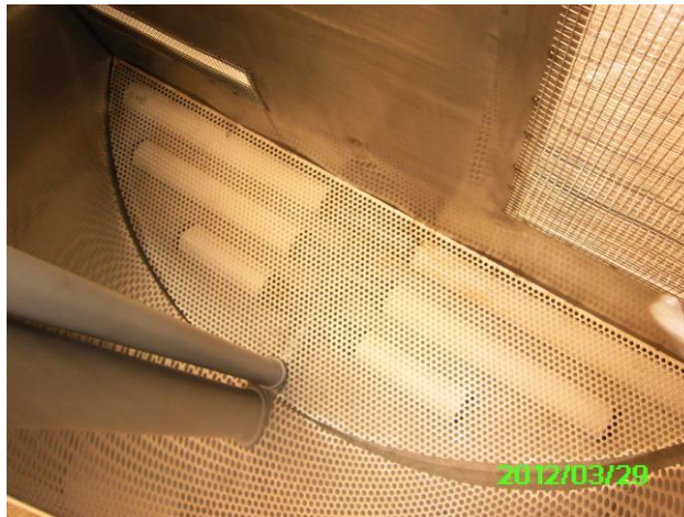
Bild 3: Nitrifikationsbelüfter mit Lochplatte zur Aufnahme von Biobällen
