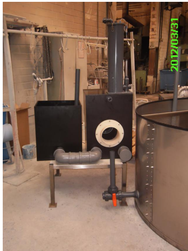
Bild 10: Bypass-Verrohrung zum Trommelfilter, Pumpenkammer und Abschäumer
