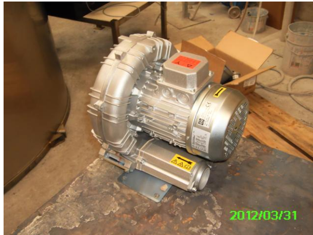
Bild 12: Seitenkanalgebläse für Nitrifikation
