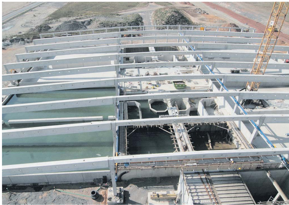
Die Becken der Fischzuchtanlage sind für Tests schon einmal befüllt worden.
